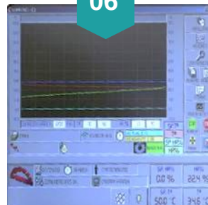
06/ sistema de control
